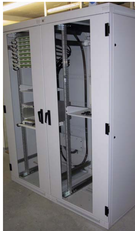
Bereits gestellter Schaltschrank im UG-Bereich der Liegenschaft Sackzelg 34 – 36, welcher einen Knotenpunkt der Glasfaserleitungen des neuen, eigenständigen TV-Kabelnetzes innerhalb der Siedlungen in Albisrieden aufnehmen wird.
