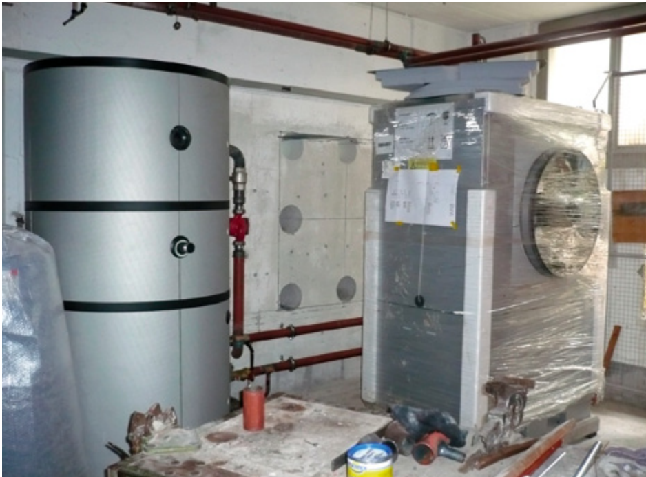
▲ Speicherboiler und Luft/Wasser-Wärmepumpe.
