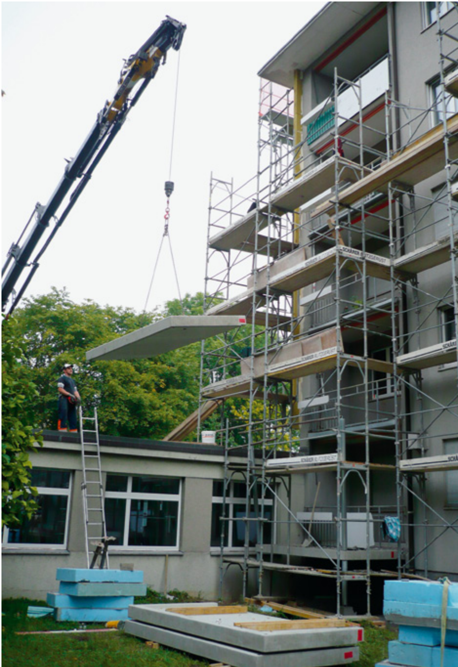
▲ Am Haus Fellenbergstrasse 184 werden mit einem Pneu- kran die angelieferten Betonplatten der neu- en, grösseren Aussen- balkone gesetzt.
