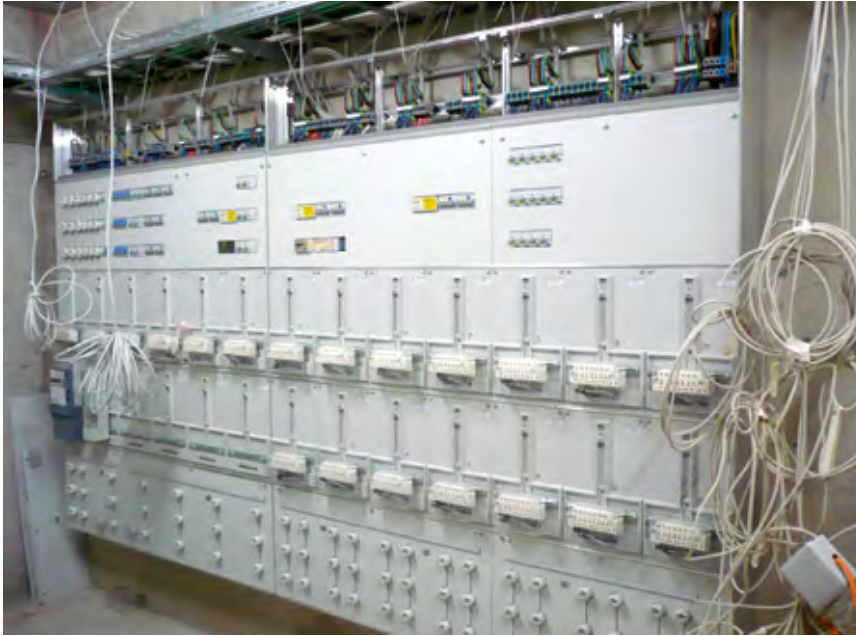
Nicht Fort Knox – «nur» Installationen im Gebäude Sackzelg
